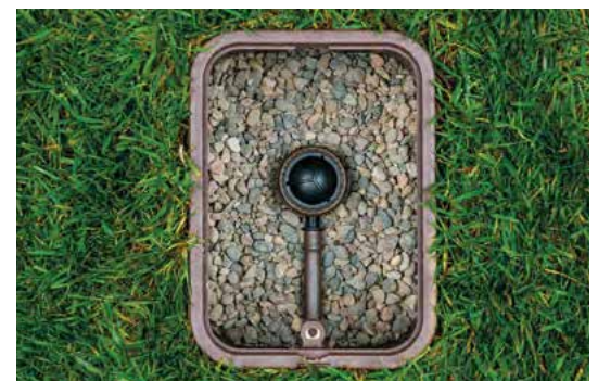
Válvula de descarga automática instalada
