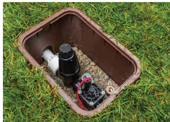
PCZ-101 instalado en una arqueta polivalente
