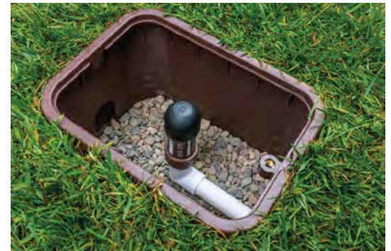
Válvula de ventosa de aire/vacío instalada
