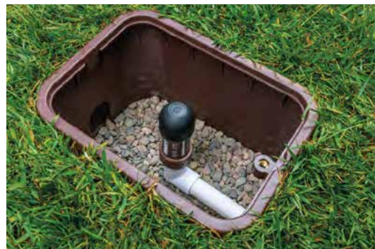
Électrovanne de purge air/vidé installée
