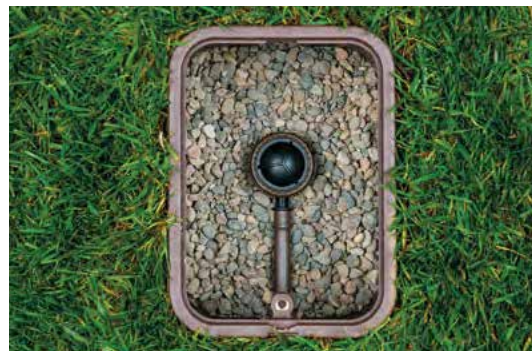
Électrovanne de purge automatique installée
