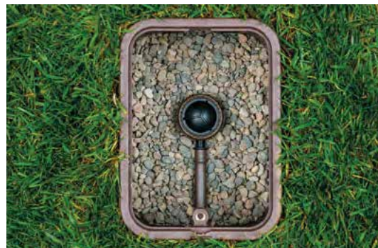
Valvola di spurgo automatico installata
