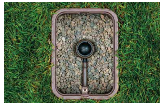
Válvula de descarga automática instalada
