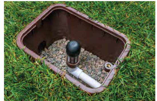
Válvula de alívio de vácuo/ar instalada
