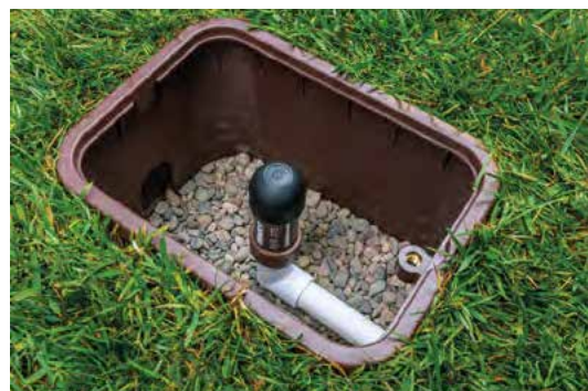
Nainštalovaný vzduchový/vákuový poistný ventil
