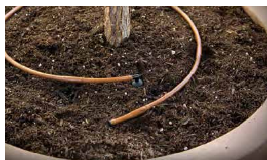
Nainštalované potrubie MLD
