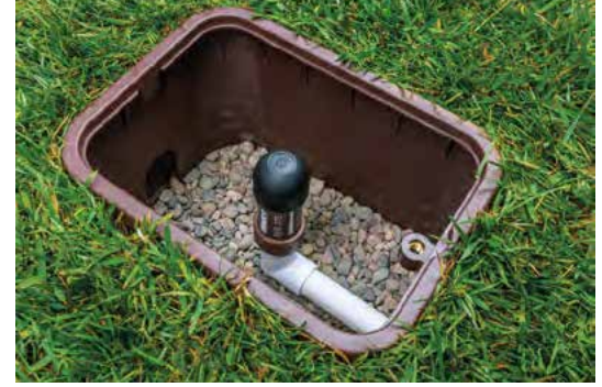
Hava/Vakum Tahliye Vanası Takılı
