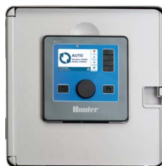
Ovládací jednotka zavlažování
