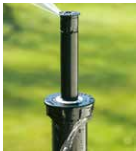
其它品牌: 喷头体盖有明显漏水
