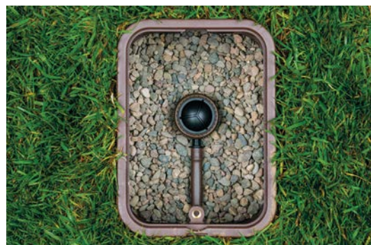
Électrovanne de purge automatique installée
