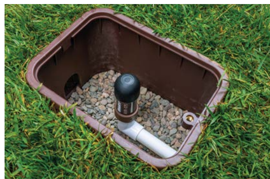
Électrovanne de purge air/vidé installée
