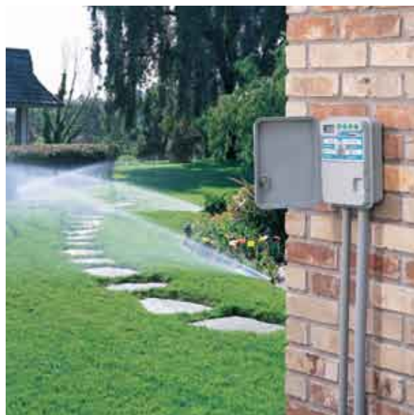
Un programmeur enregistre les jours, les heures de début de cycle et les durées d'arrosage de chaque réseau.
