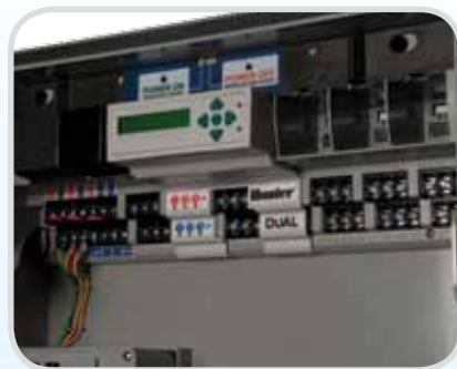
Module DUAL48M installé
